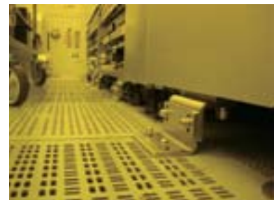
进行了抗震加固的装置
