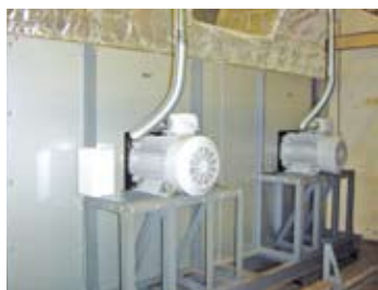
幸田技术中心的空调设备
